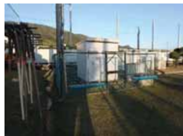
【陸上競技場キュービクル】
